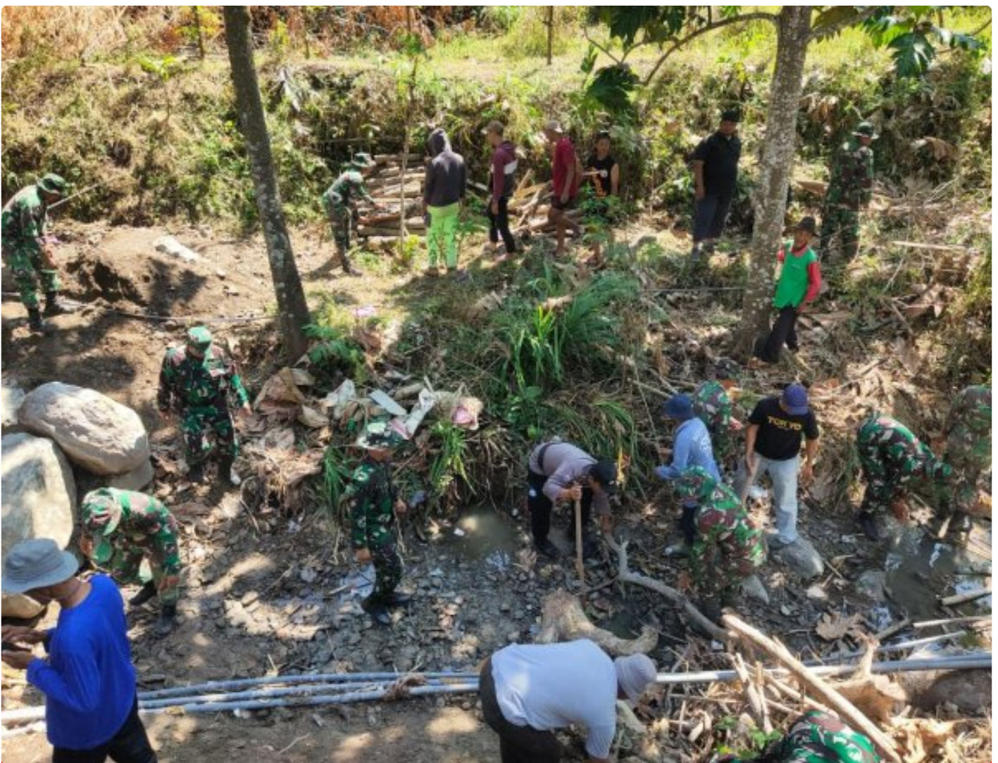
Foto: Personel Satgas TMMD Ke 121 Kodim 0720/Rembang Melaksanakan Gotong-royong Membersihkan Sungai Labuhan kidul sepanjang 400 meter bersama-sama Masyarakat Desa dan Polri, Minggu 18 Agustus 2024.
